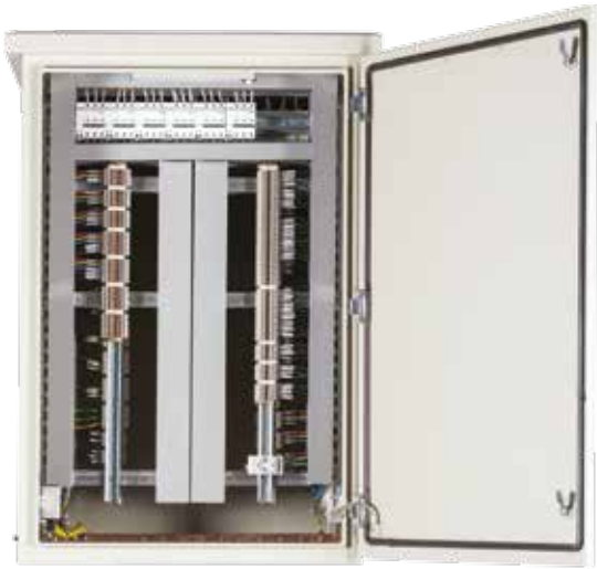
Saha Dağıtım Kutusu Marshalling Kiosk
